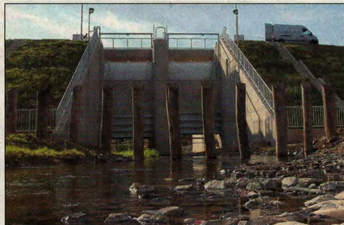
Das Becken: Schwillt die Erpe bei Regen an, macht das Auslassbauwerk die Schotten dicht. Die Eichenstämmen halten Treibgut zurück.
