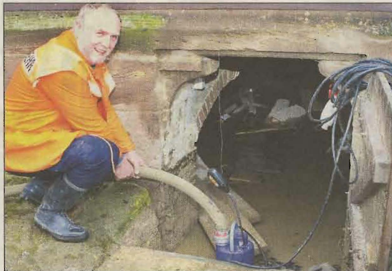
Den Keller befreien: Jürgen Schmerbeck, selbst Feuerwehrmann, pumpt das Wasser aus seinem Keller in Ehringen.
